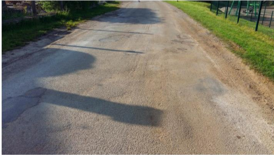
Aperçu des dégradations de la section 1
