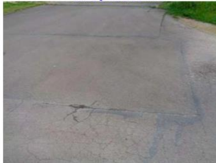
Dégradations de chaussée (faiénçage)
